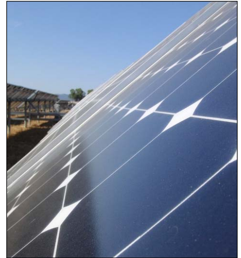
Solaranlage. Unter den Energieträgern dominiert inzwischen Photovoltaik.
